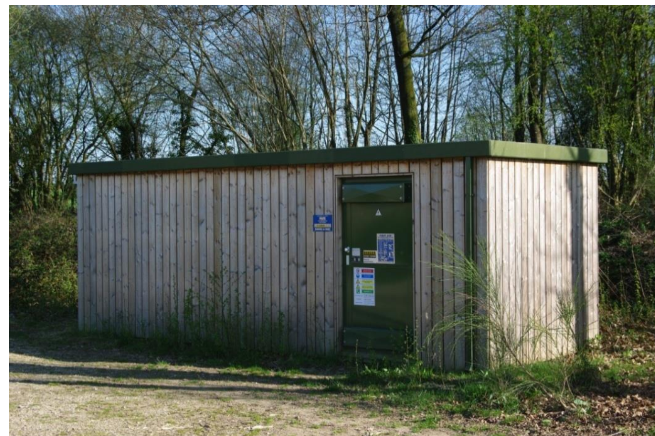
Photo 3 : Poste de livraison standard
